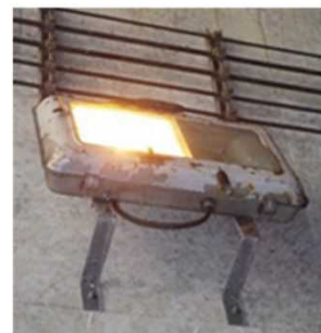
鳥田目トンネル 照明灯
