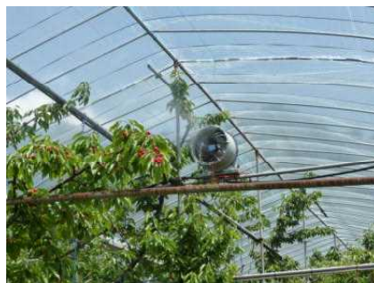
おうとう雨よけハウスの上部 に設置した細霧冷房装置
